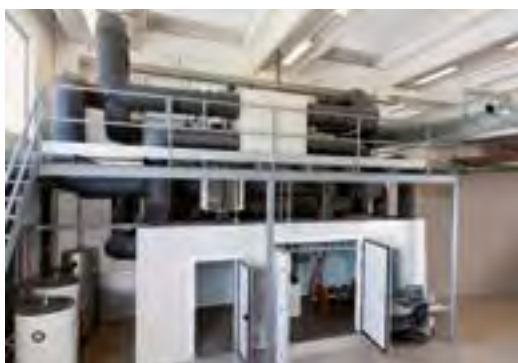
Klimatická komora pro testování rekuperačních jednotek
